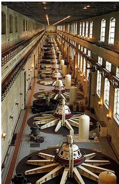
На Жигулевской ГЭС уже работают экологически чистые гидроагрегаты нового поколения
